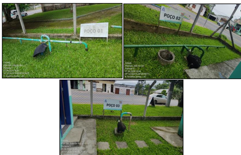
Figura 3 - Poços para captação de água subterrânea
