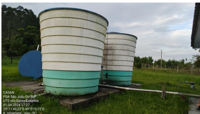
Figura 9 - Tanque de contato e reservatórios apoiados da UTS VSC
