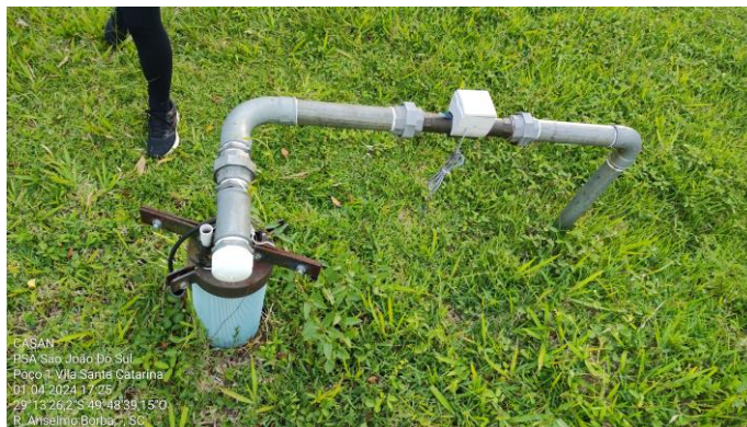
Figura 8 - Poço de captação de água subterrânea
